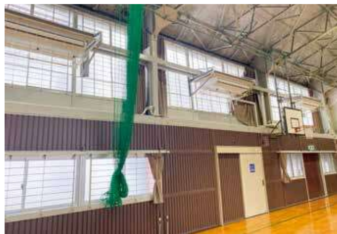
北部地域の災害には欠かせないとして設置された北小学校の空調設備。南小学校、北中学校にも設置を。
