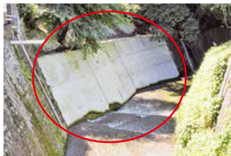
竹原区の損壊した護岸
