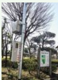
御嶽堂公園前に設置された防犯カメラ
