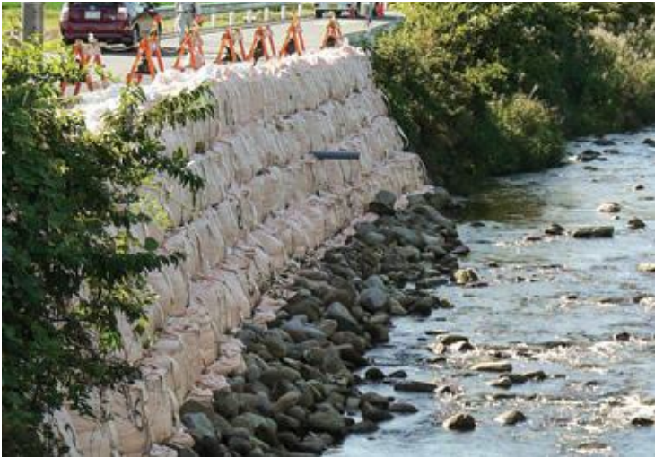
7月の大雨で護岸が削られた桃沢川
