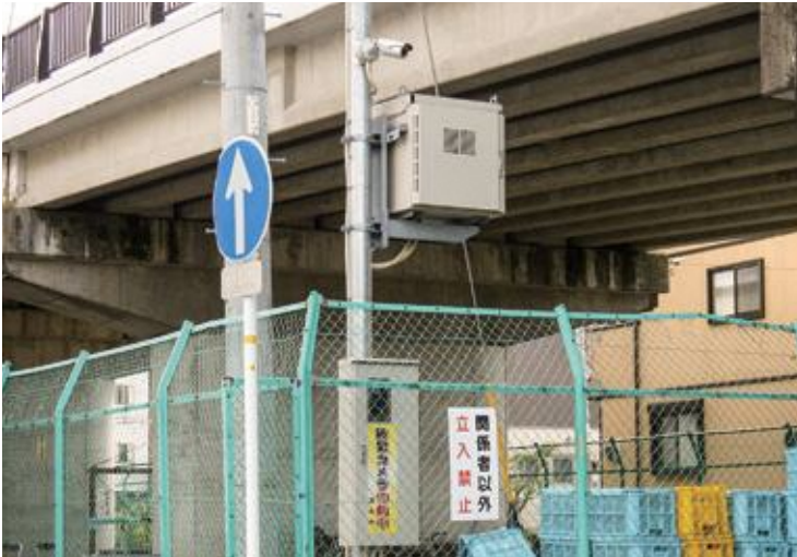
竹原陸橋北側高架下に設置された防犯カメラ
