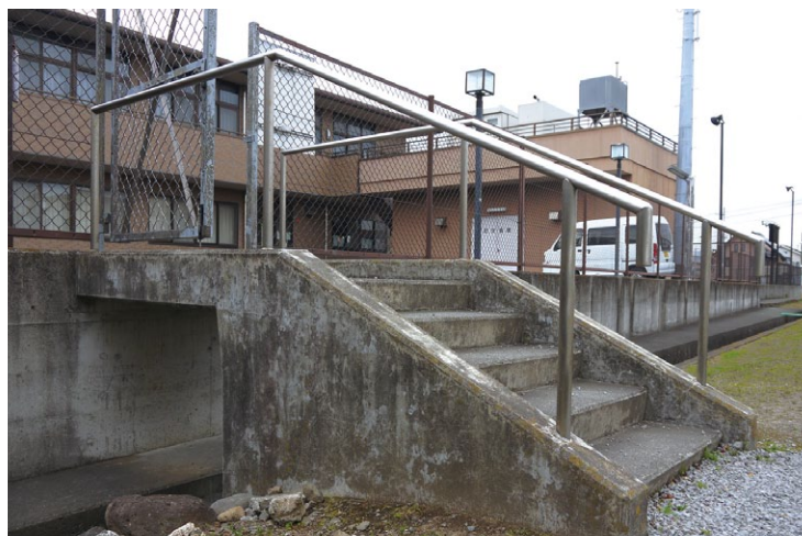
段差解消が望まれる地区センター駐車場
