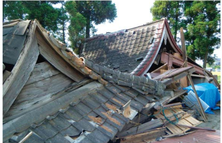
被災地へ派遣された職員が撮影した倒壊した建物
