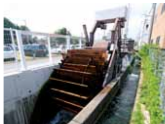
▲小水力発電装置 (発電量は平均5 kW/h)
