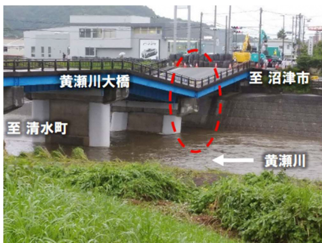
図2-22 黄瀬川大橋の被災状況
