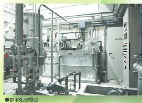
●排水処理施設
