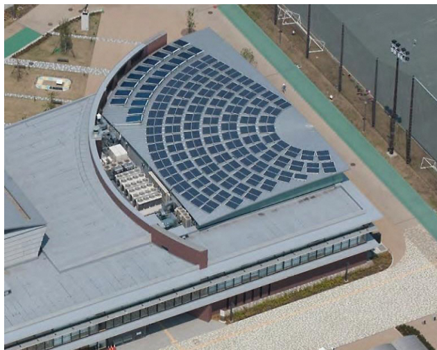
ウェルピアながいずみの太陽光発電・太陽熱利用
