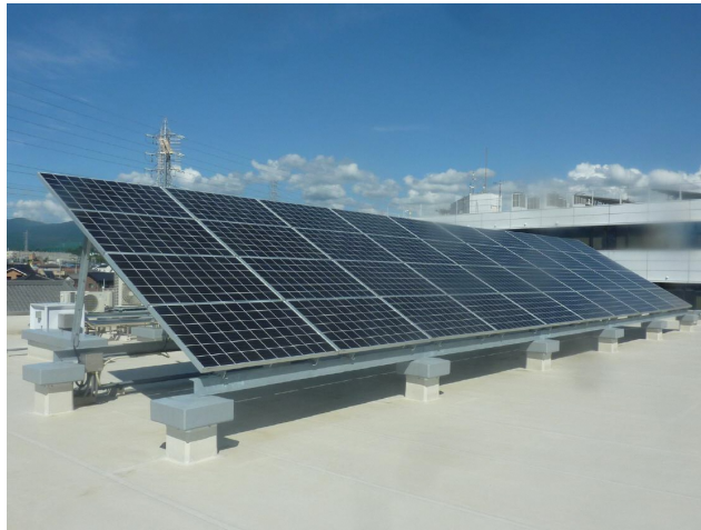
防災センターの太陽光発電
