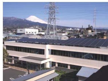
長泉町役場北館の 太陽光発電システム
