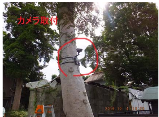
監視カメラの設置
