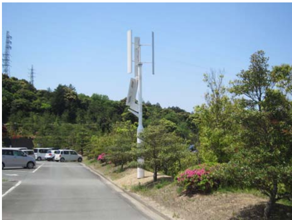
⑯ 風力発電による省エネルギー化
