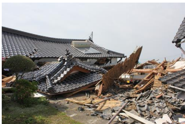
【H28. 4. 14 発生 熊本地震】 木造住宅の倒壊
