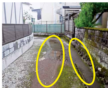
未舗装で側溝がなく、雨が降ると水たまりができる。
