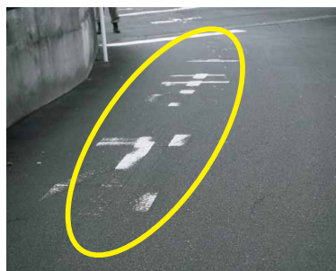
止まれの路面標示が消えている。
