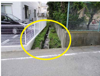
柵もなく転落の危険がある。
